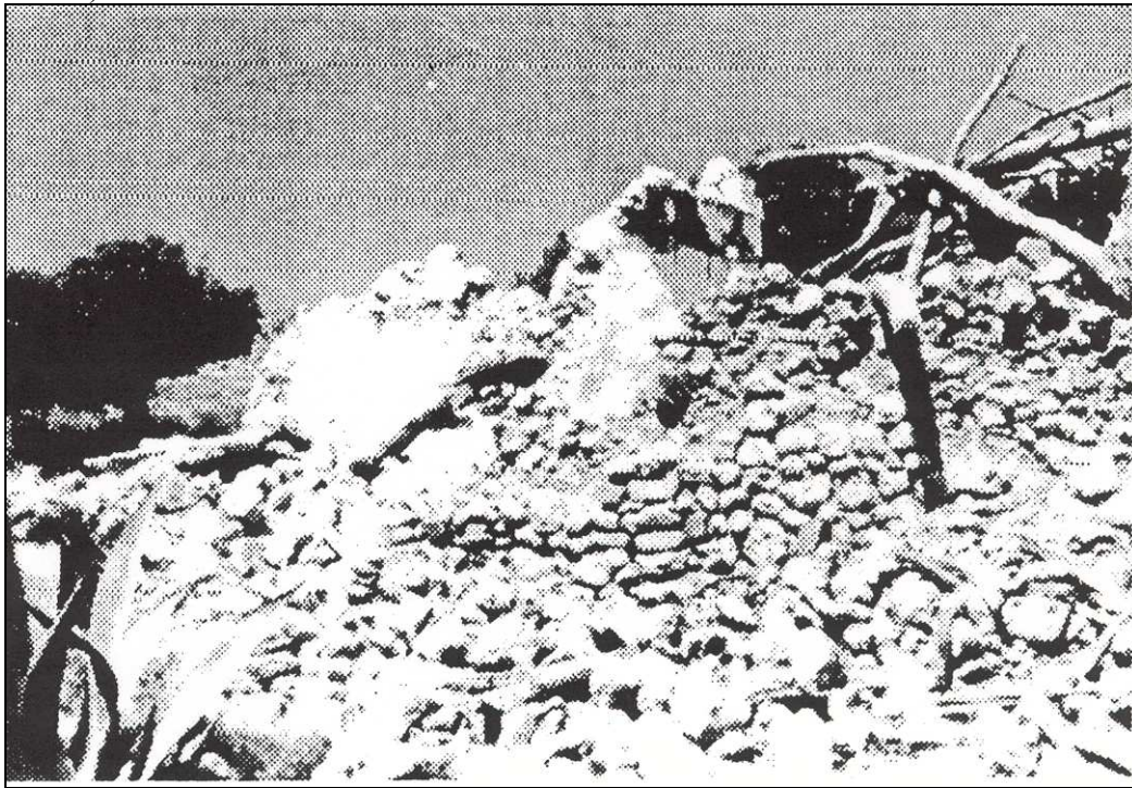
Photo 2. Destruction totale du marabout Si Haj Ahmed à Tafensa (Séisme d'Al Hoceima du 26 mai 1994).
